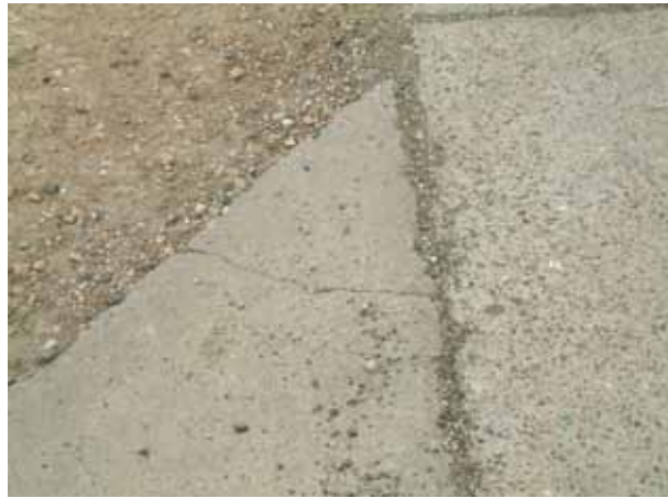
8 Riss an einem Zwickel
