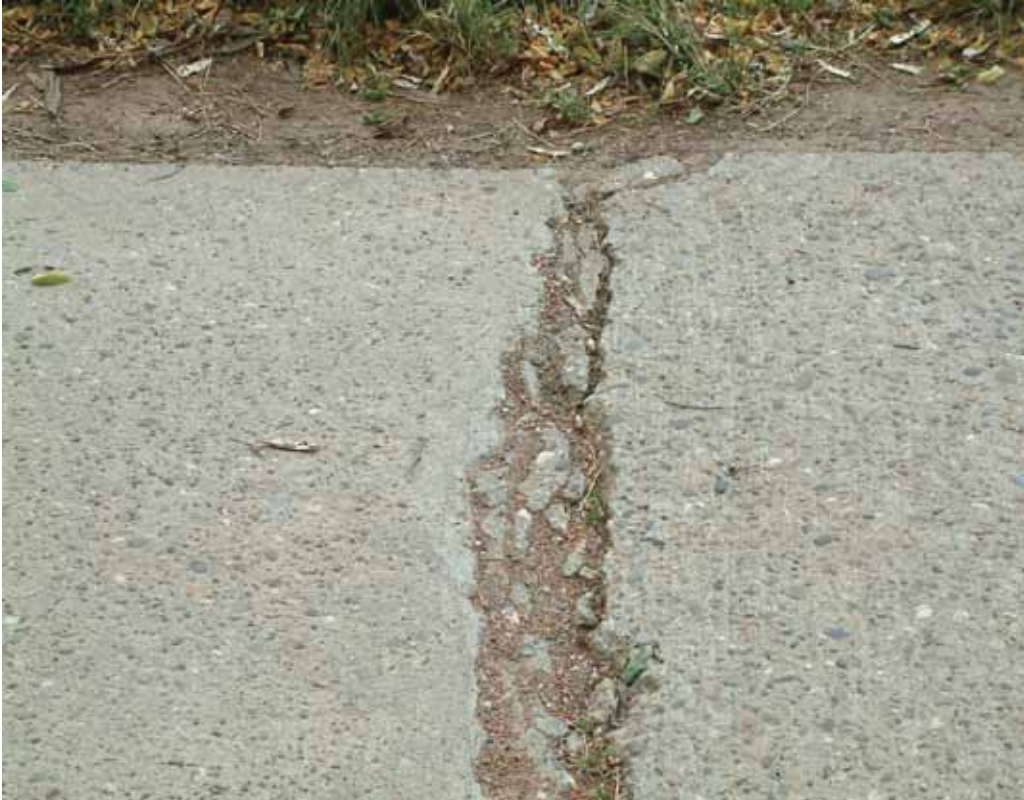
4 Kantenabbruch infolge mangelhafter Verdichtung in der Fuge
