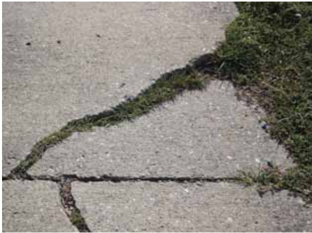
7 Eckabbruch mit Absackung
