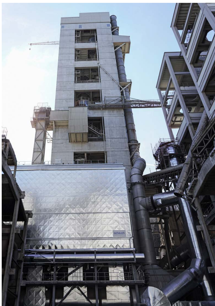
DeCONOX-Anlage in Gartenau
